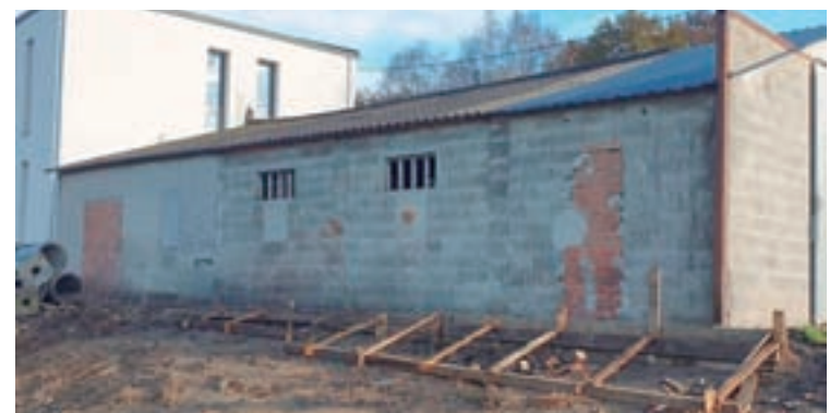
Un dos edificios do Concello en mal estado
